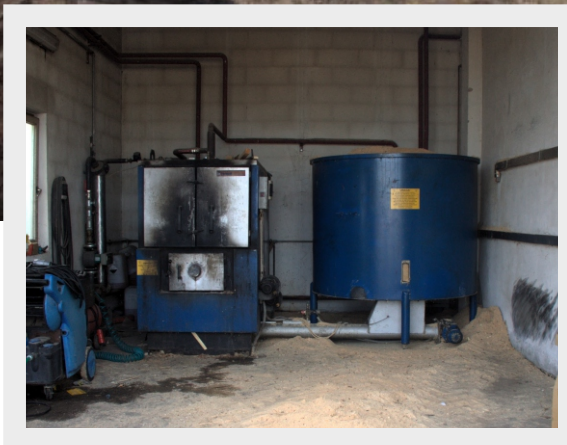
Piec przystosowany do spalania trocin, z którego energia cieplna ogrzewa suszarnię drewna
